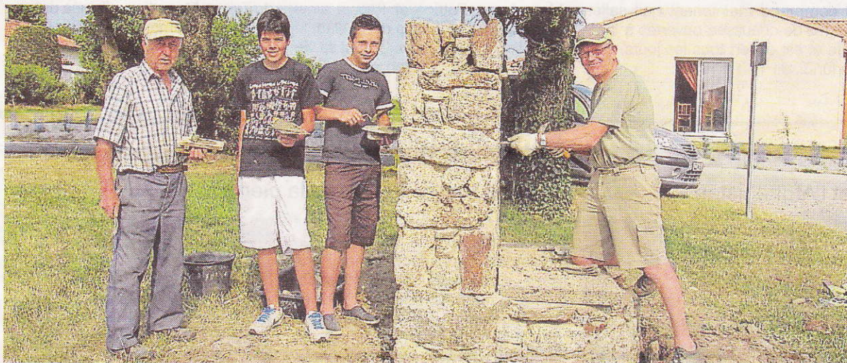
Deuxième site du chantier : la Papinière où le puits du village a été restauré par Brice et Bastien, jeunes habitants du lieu, avec Dédé et Jean, membres de l'association du Patrimoine.
